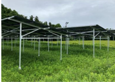
＜営農型太陽光発電所＞
