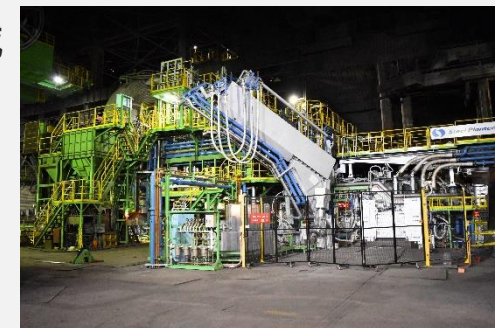
竣工した新電気炉
