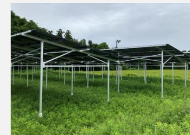
稼働中の営農型太陽光発電所
