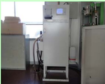
圧延工場TOC計
